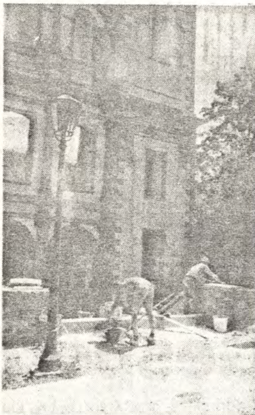
Südfassade der Klosterruine, an der umfangreiche Restaurierungsarbeiten durchgeführt werden (Mitte). Im Außenbereich der Klosteranlage werden derzeit die Treppen erneuert. Fotos: Gysser
